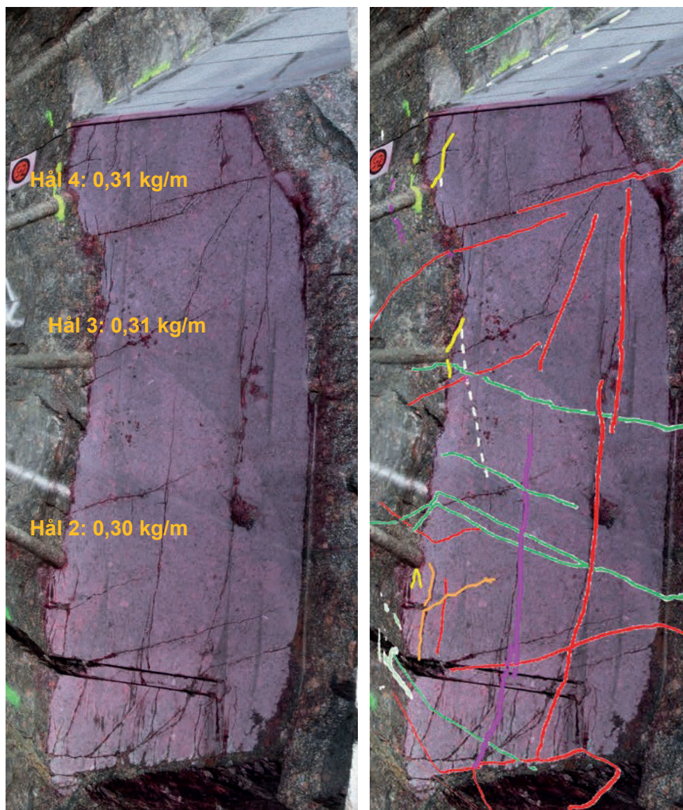
Figur 40. Snittytan TASN sektion 12 m, riktning ut med penetrantvätska samt tolkade spricktyper.
