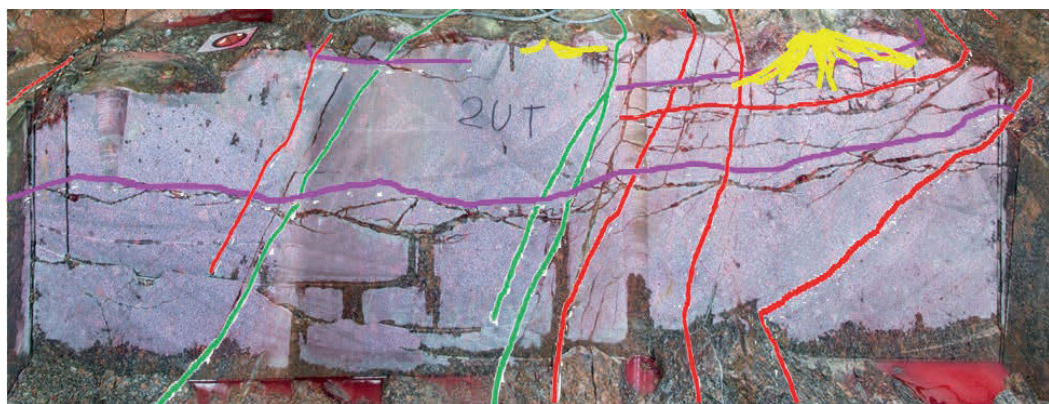
Figur 48. Snittytan TAS 04, Sula sektion 34 m, riktning ut med penetrantvätska samt tolkade spricktyper.
