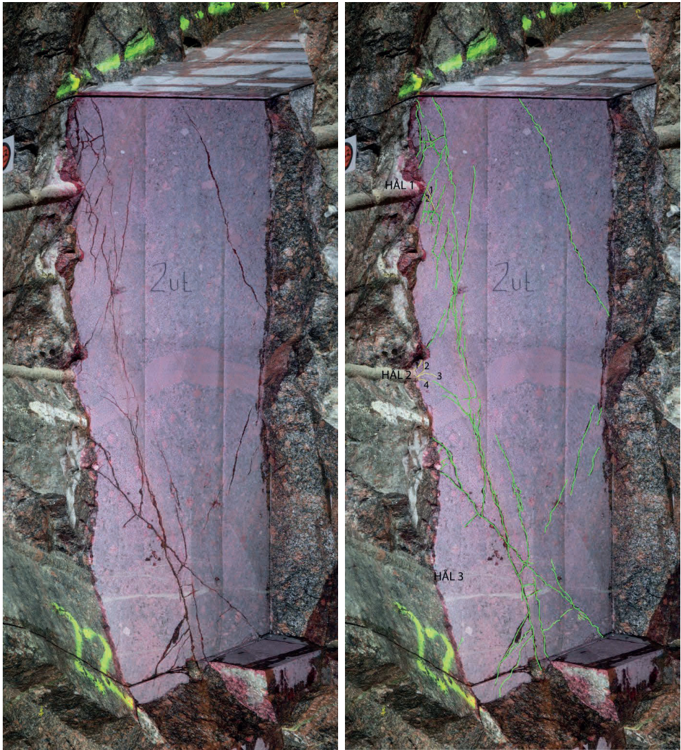
Figur 34. Snittytan TAS04, sektion 22 ut med penetranter samt med inlagda spricktyper.
