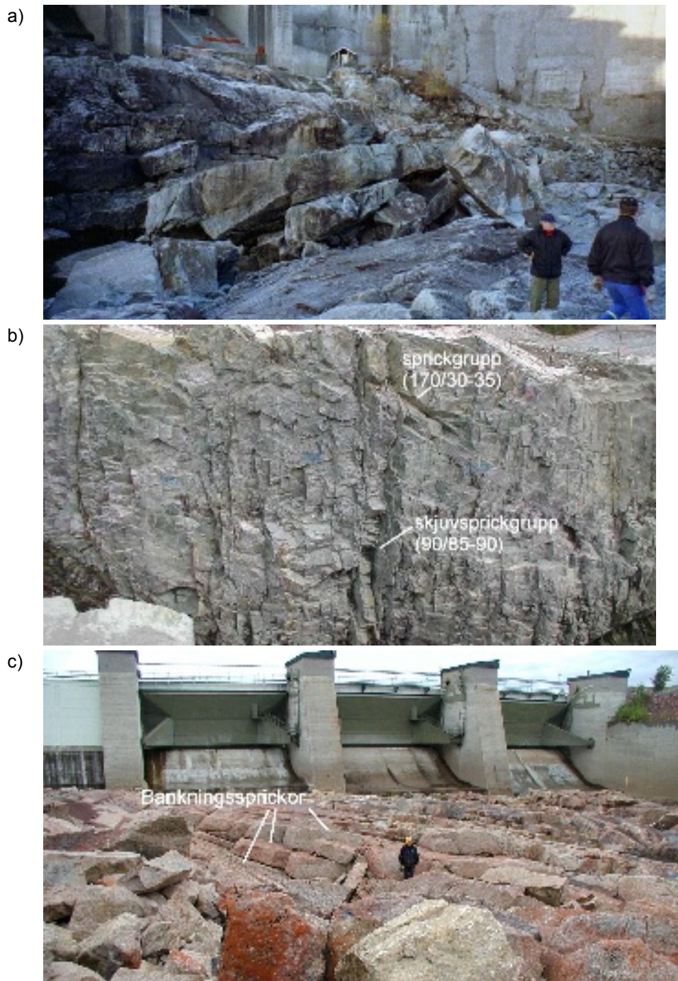
Figur 3 Bergförhållanden vid de olika studerade anläggningarna: a) eroderade block nedströms utskoven i Midskog, b) vänster vägg i utskovskanalen i Satisjaure, c) nedströms utskoven i Harsprånget.
